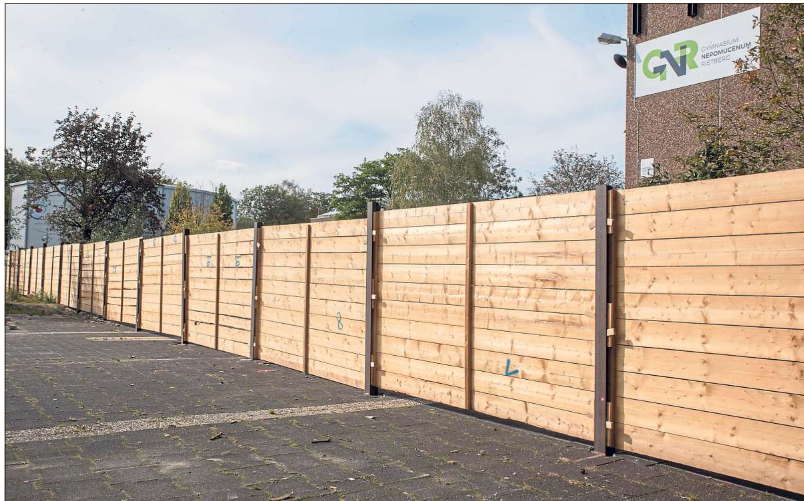
Nicht schön, aber notwendig: Seit dem Ende der Sommerferien ragt entlang des Rietberger Schulzentrums ein wuchtiger Bauzaun auf. Hinter der Absperrung entsteht in den nächsten Jahren der Neubau für das Gymnasium Nepomucenum. Foto: Brandt
