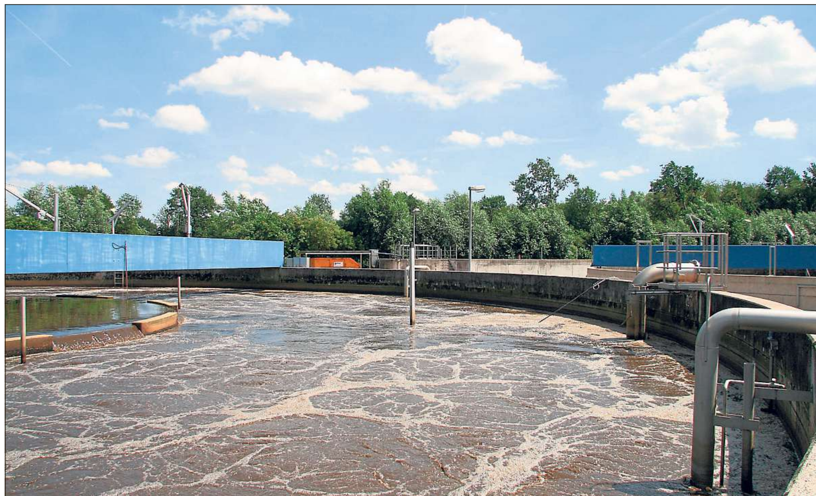
Damit es auch künftig noch so schön sprudelt in den Becken des Klärwerks, sollen die Gebläse ausgetauscht werden. Sie entsprechen schon lange nicht mehr dem Stand der Technik. Neue Modelle verbrauchen unter anderem deutlich weniger Energie. Bild: von Stockum
