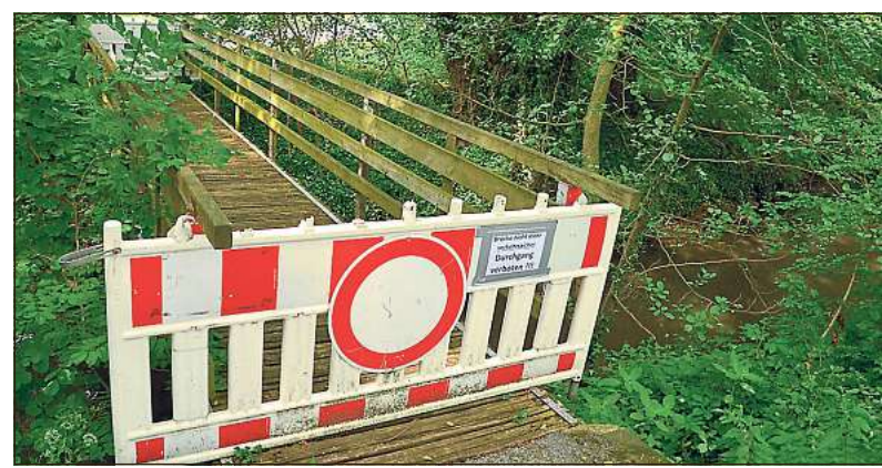
Einen wirtschaftlichen Totalschaden attestierten Fachleute dem Brückenbauwerk über den Wapelbach in Neuenkirchen.
